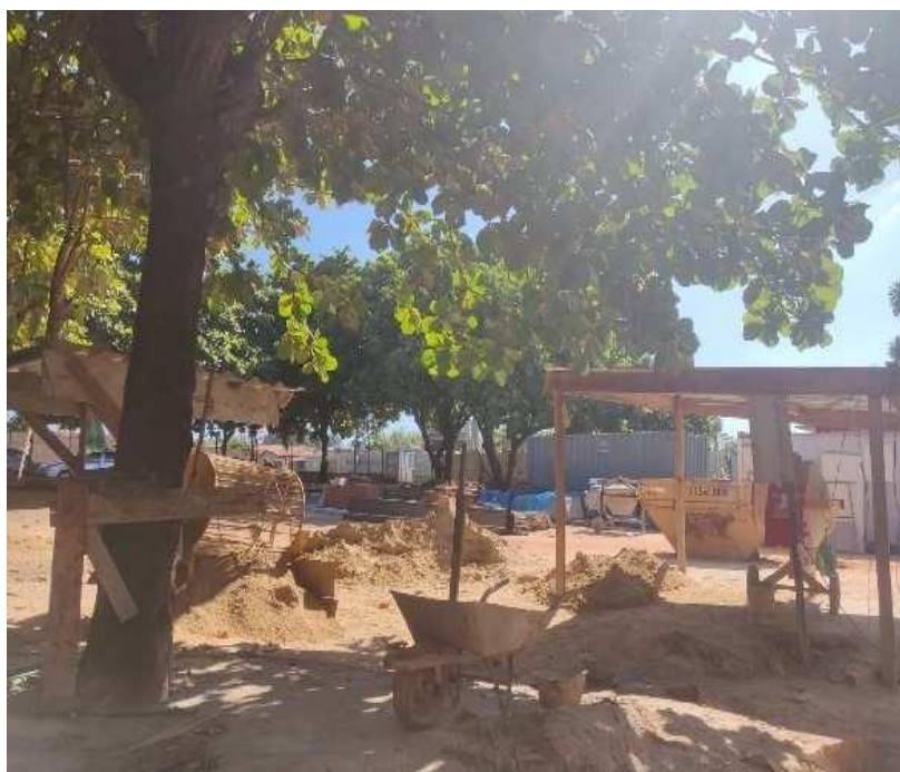
Demolição do pavimento, movimentação de terra e retirada de todas as árvores do local para o novo acesso a edificação
